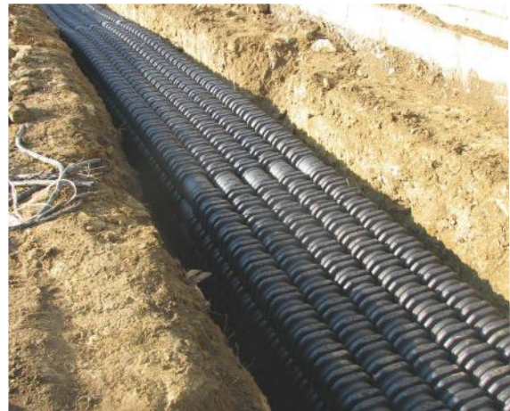
省スペースの配管
